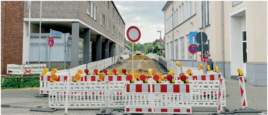
Die Baustelle an der Einmündung Pallottistraße in die Straße „Am Voigtstor“, Foto: Stadt Rheinbach
